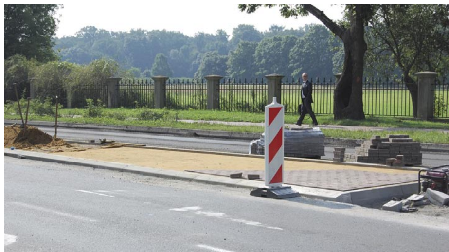
Powstałe azyle dla pieszych oraz elementy narażone na ruch pojazdów wyłożono kostką
