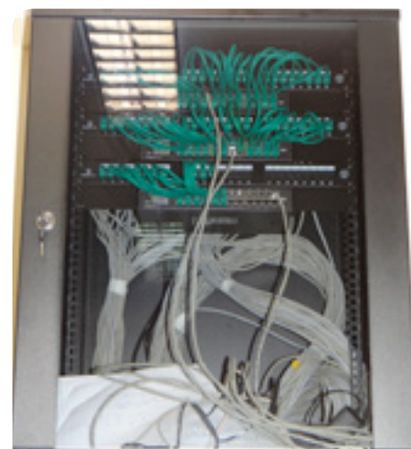
Instalacja sieci SP Jabłonna
